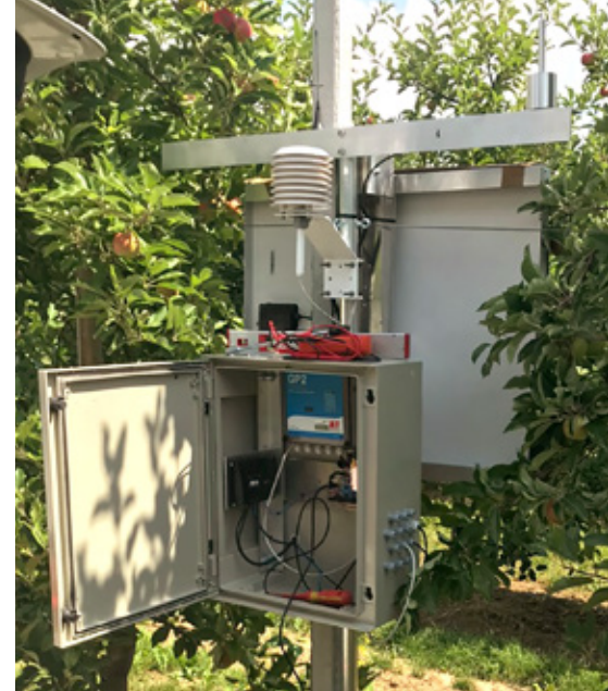
Foto 5: Klimamonitoring in der Anlage.
